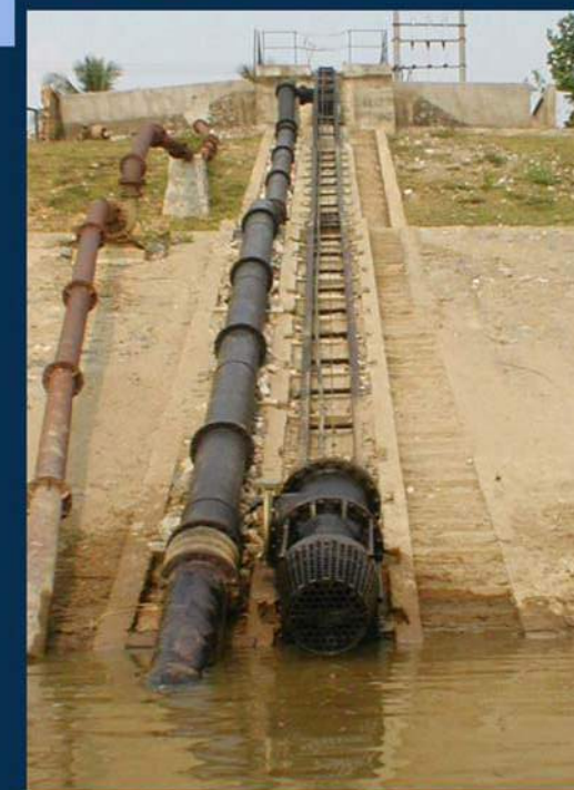
TRẠM BƠM CẨM GIANG (2003)
